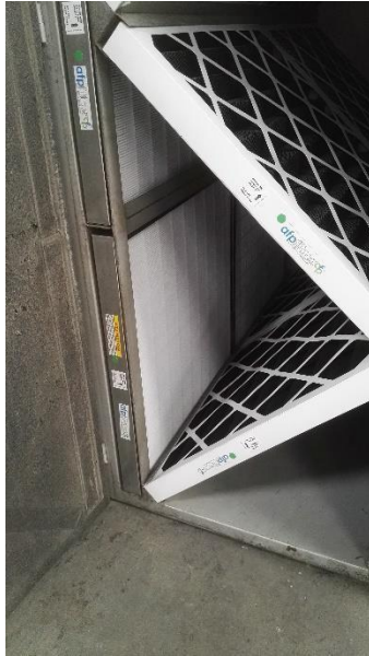
FILTROS AFP-50 y 60 INSTALADOS
